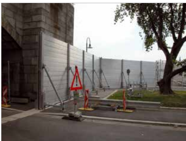
Abb. 7-5 Aufbau eines Dambalkensystems in Linz (Fotos: Magistrat der Stadt Linz)
