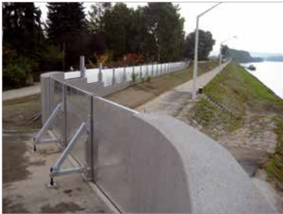
Abb. 7-4 Dambalkensystem (Foto: Wernerconsult)
