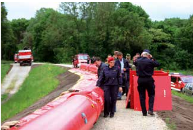
Abb. 7-26 Geschlossenes Behältersystem, schlauchförmig (Foto: BFKDO Gänserndorf)
