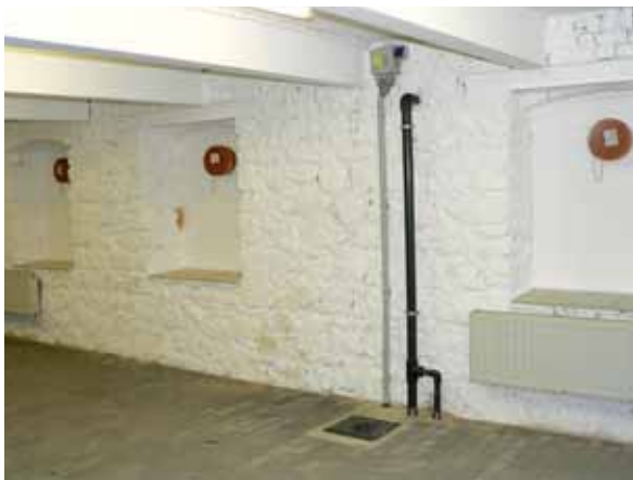
Abb. 3: Beispiel für einen Pumpensumpf (Quelle: R+V Allgemeine Versicherung AG)
