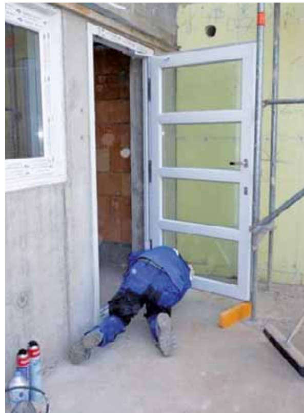
Abb. 12: Beispiel für eine wasserdichte Tür (Quelle: Modell Poseidon, Alpina Hochwasserschutzfenster GmbH, www.alpinafenster.de )
